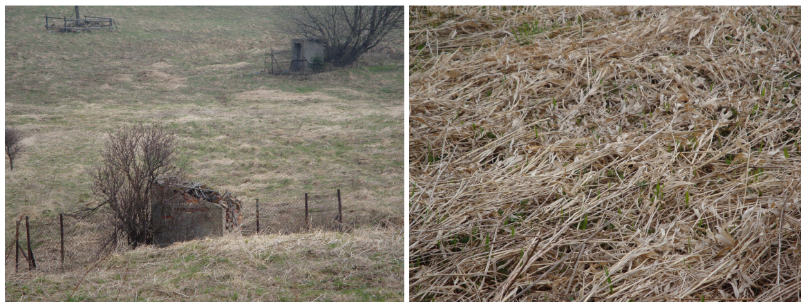
Fot. 1 Zdewastowane obudowy ujęć drenażowych na Hali pod Klinem (12.04.2011)
